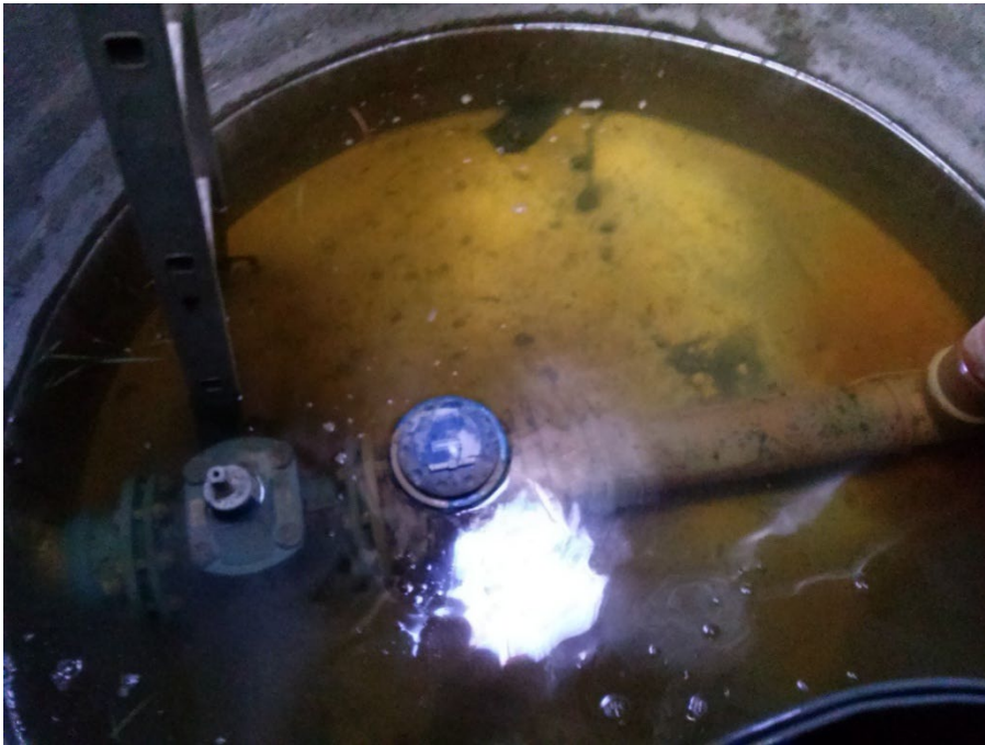
Foto 11: Blick in den Ablaufschacht mit Schieber und Durchflussmesseinrichtung. Der Schacht steht ca. 30 cm unter Wasser. 7.9.2020 (Lennart Gosch)
