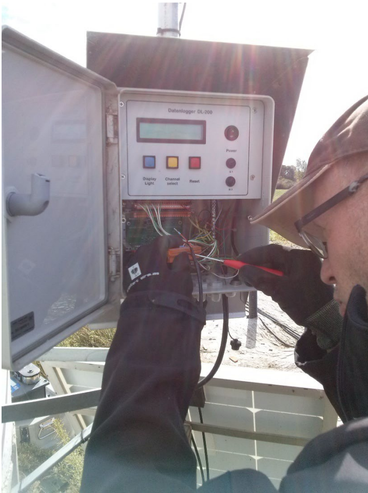
Foto 12: Wartungsarbeiten am Datenlogger. 7.9.2020 (Lennart Gosch)
